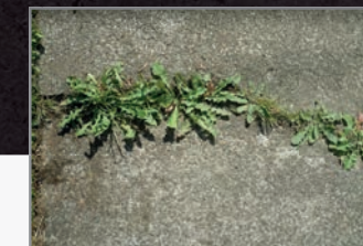
Ukrudt på fortovet
