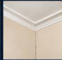
Minor drywall crack
