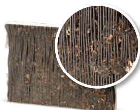
Senza manutenzione del sistema A/C
