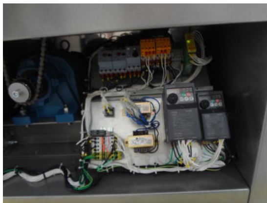
Painel Elétrico na Face Lateral Esquerda
