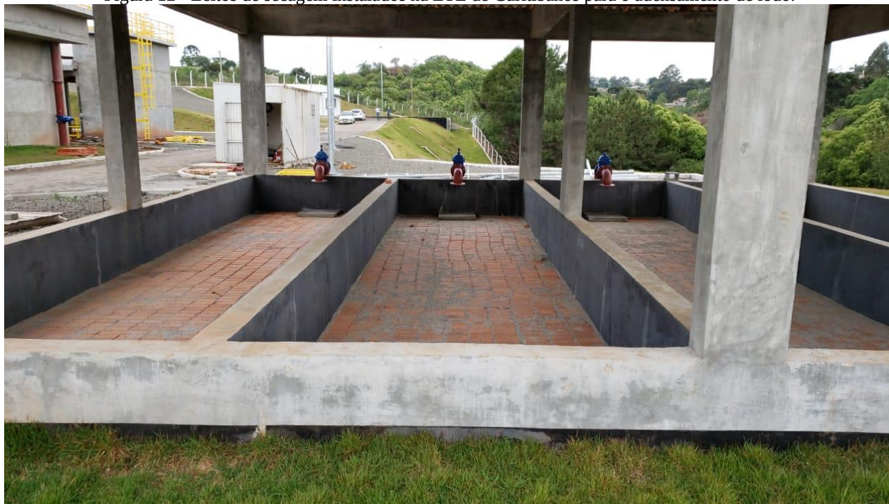
Figura 12 - Leitos de secagem instalados na ETE de Curitibaanos para o adensamento de lodo.
