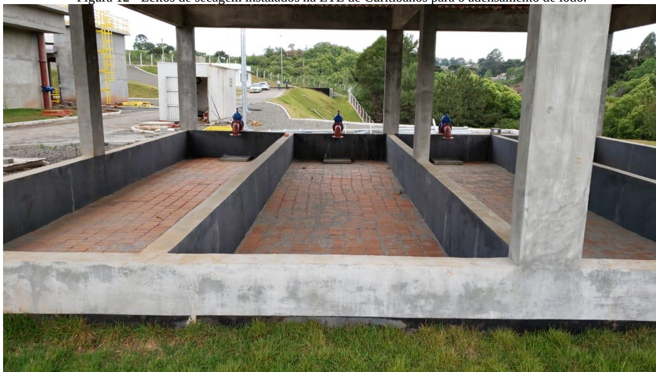
Figura 12 - Leitos de secagem instalados na ETE de Curitiba para o adensamento de lodo.
