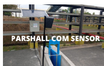
ULTRASSONICO PARA CALHA PARSHALL COM SUPORTE PARA O SENSOR E KIT SOLAR
