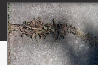
Mauvaises herbes sur un trottoir 2 à 5 jours après le traitement
