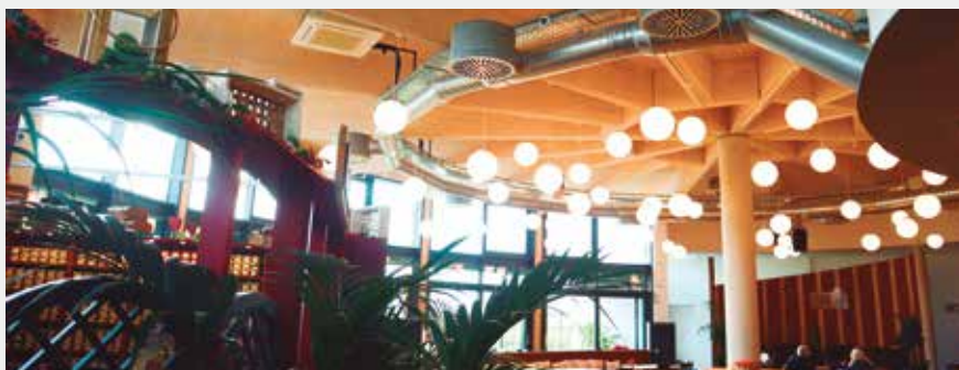
Macelleria Weinbuch. Punto vendita - Ristorante. Öpfingen, Germania. VRF, residenziale e refrigerazione.
